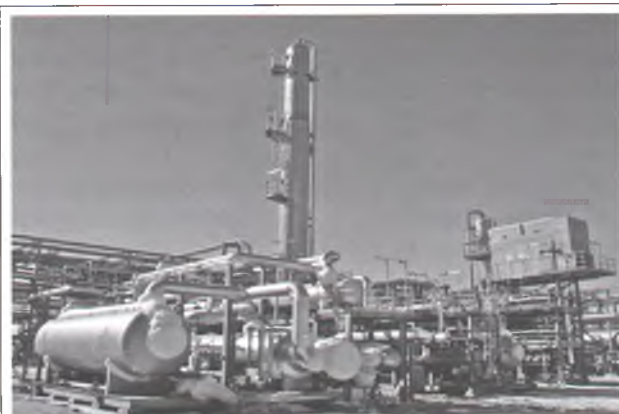
Установка низкотемпературной конденсации и дезанизации
