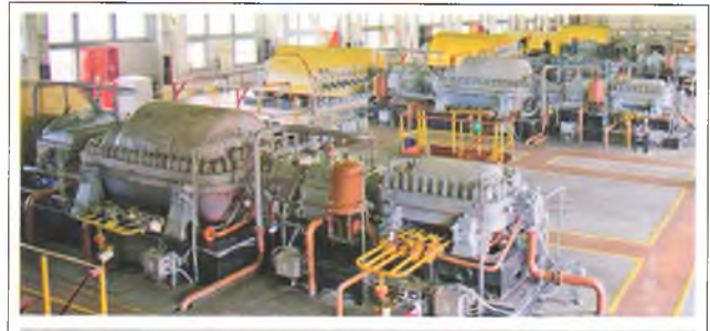
Рис. 6. Блок компримирования газа
