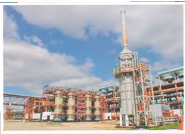
Рис. 2. Красноленинский газоперерабатывающий завод
